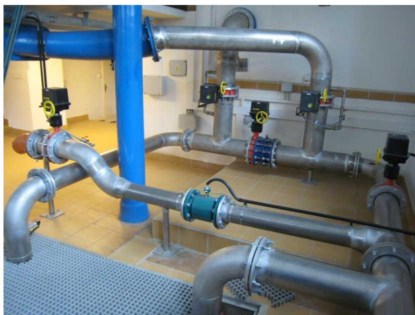
Obr. 2 Pohled na inovovanou ČS – dvě výtlačná potrubí, napájení čtyř měrných tratí
