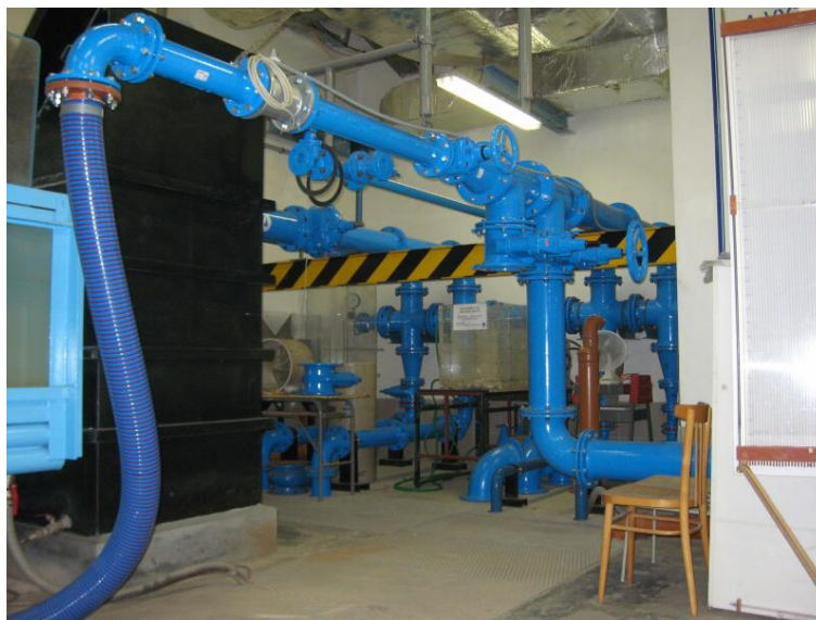
Obr. 4 Pohled na ČS – rozvodná potrubí, regulační armatury, čtyři výtlačná potrubí od čerpadel
