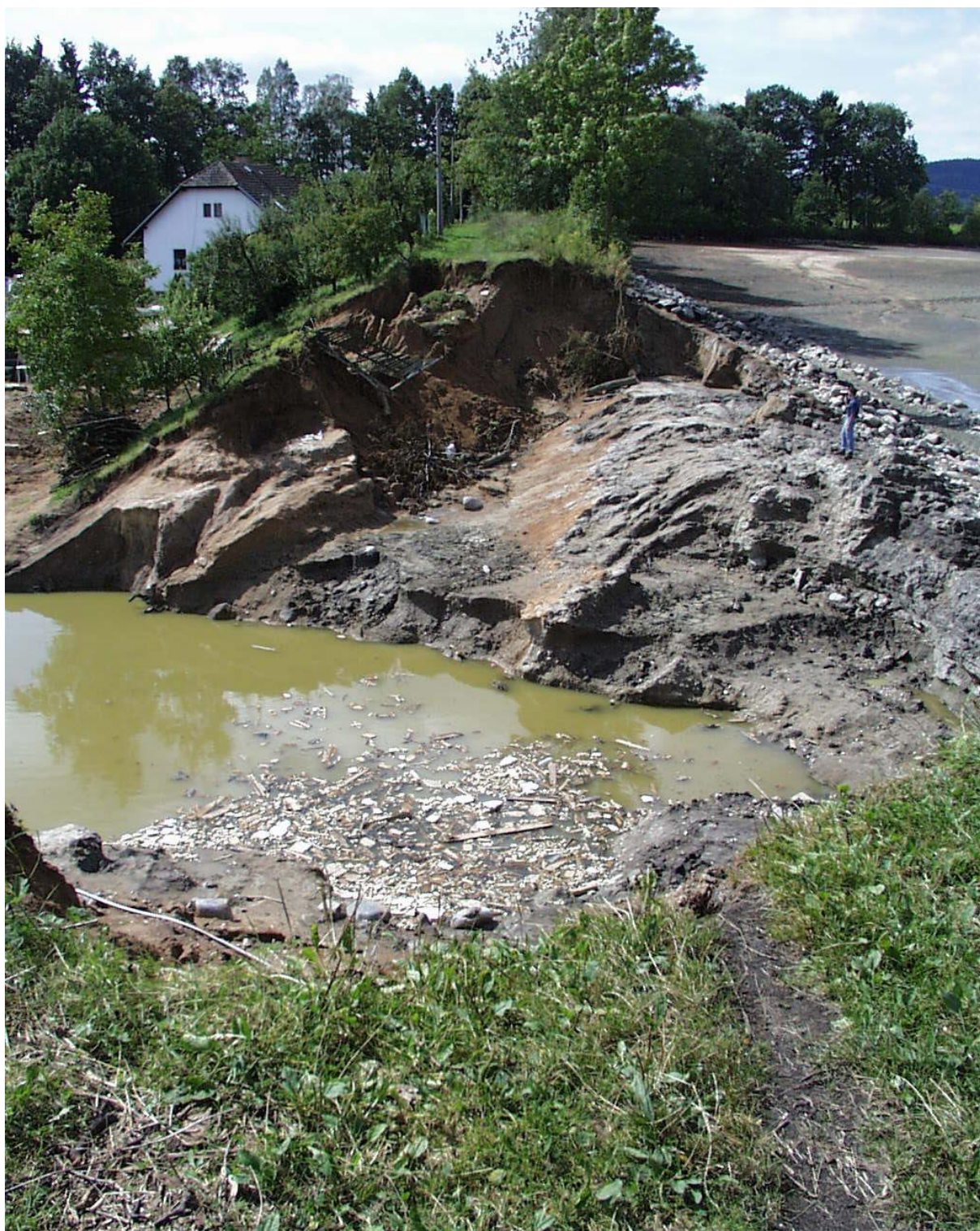
Obr. 3. Příklad protržení zemní hráze Metly 1997.
