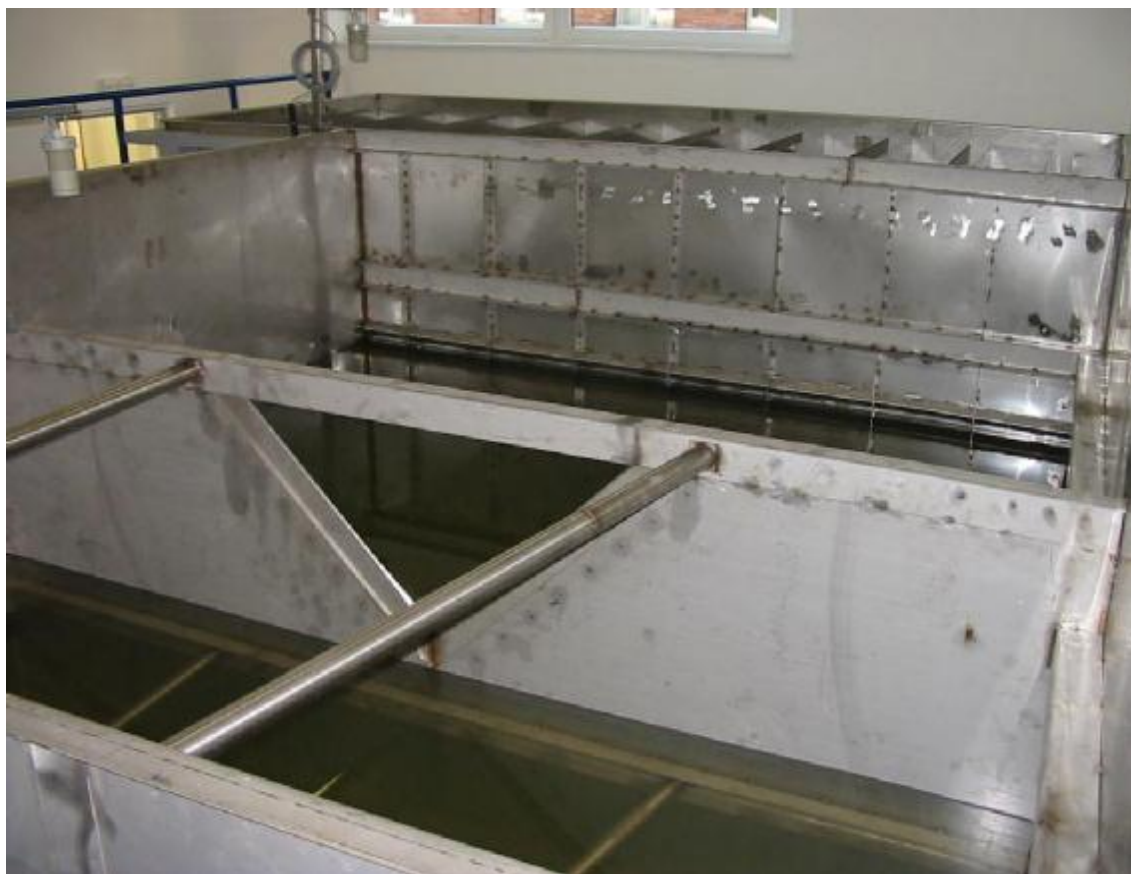
Obr 8. Pohled na horní stabilizační, měrnou a odpadní nádrž
