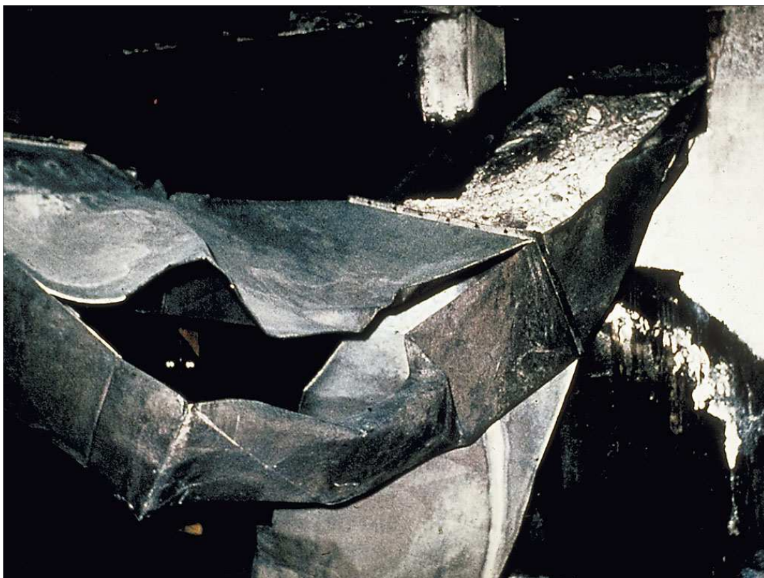
VZT potrubí z ocelového plechu po požáru.
