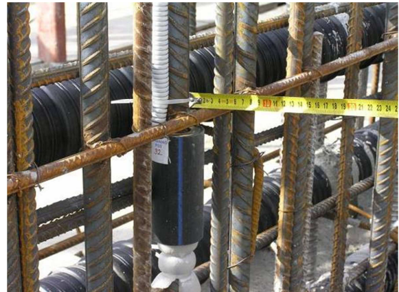
Obr. 7 Magnetoelastický snímač ME1 umístěný na tahové výztuži „zvedací“ konzoly
