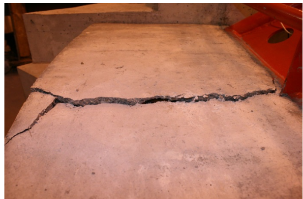
obr. 20 Trhlina v mostovce při mezním zatížení
